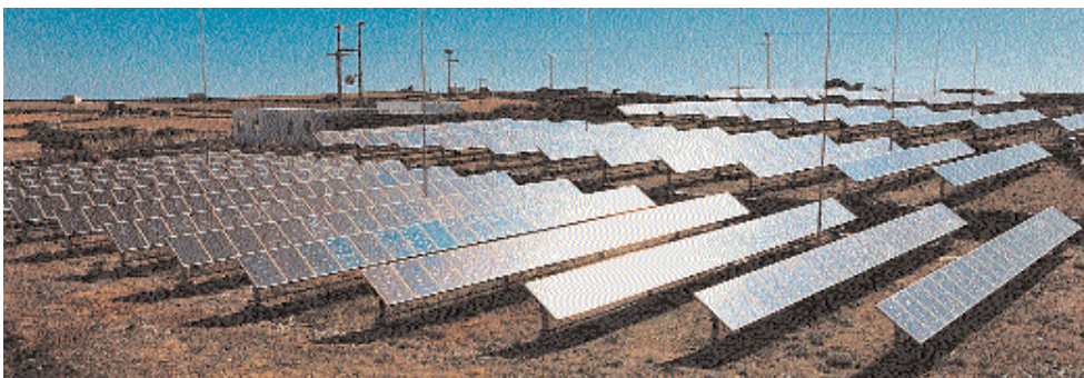
Η Δ.Ε.Η. έχει δημιουργήσει σταθμούς παραγωγής ηλεκτρικής ενέργειας με φωτοβολταϊκά στοιχεία, όπως φαίνεται στη διπλανή φωτογραφία.
